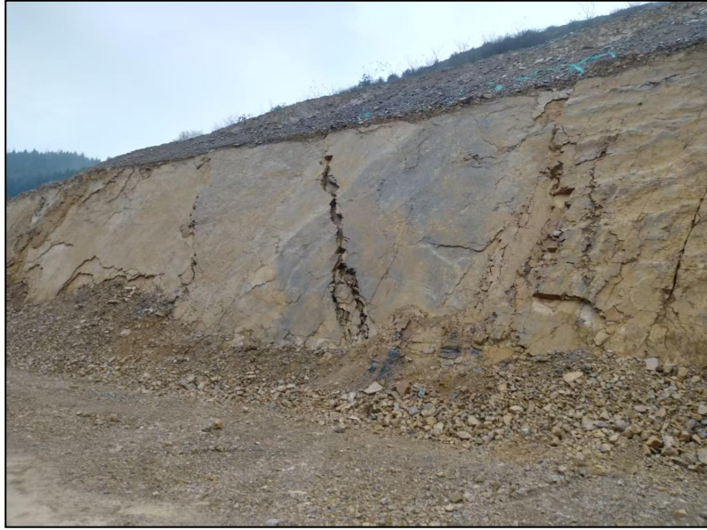
照片 2-4 矿区溶蚀裂隙
